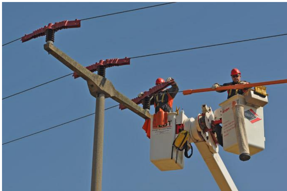
Storchenschutz an Mittelspannungsleitung.
