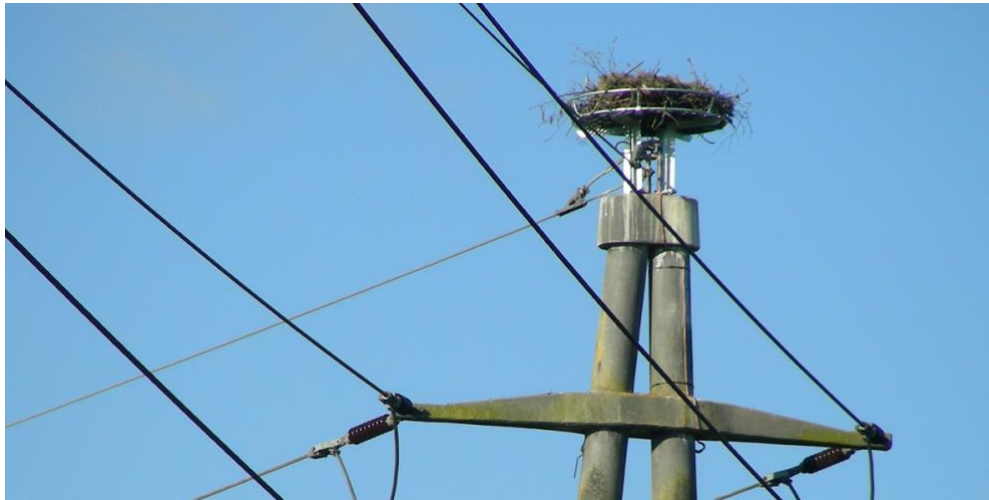
Horstunterlage mit Nistmaterial bietet Schutz vor Stromschlag.
